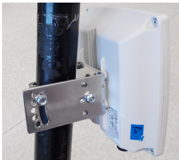
Рисунок 11 – Вид правильно установленной станции
